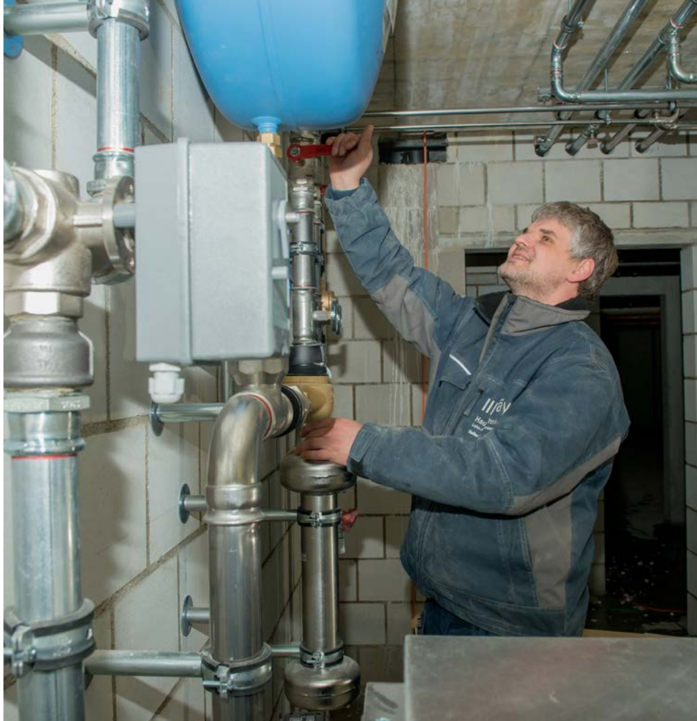
Die Lieferfristen für Wärmepumpen, Boiler und Speicher betragen zwischen sechs und zwölf Monaten.
